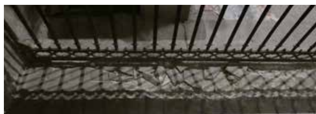
Le sol est mal adapté et abîmé
